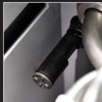
Wasser-Füllstandanzeiger zur Kontrolle des Wasserstands im Heizkessel
